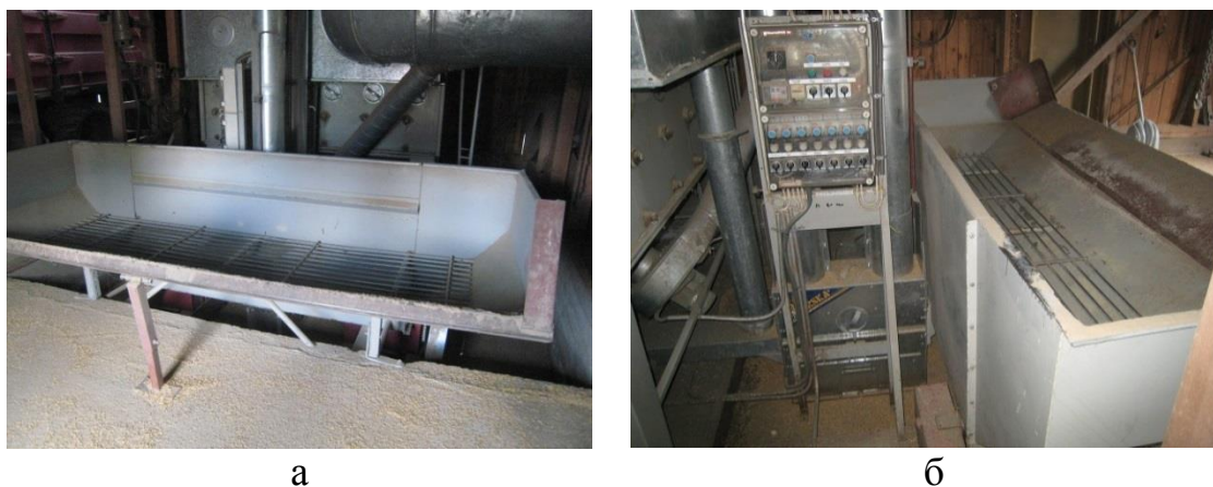
Фото 2. Напольный приемный бункер, установленный перед сушилкой «Arska» (Финляндия): а – вид спереди (справа); б – вид сзади (слева).
